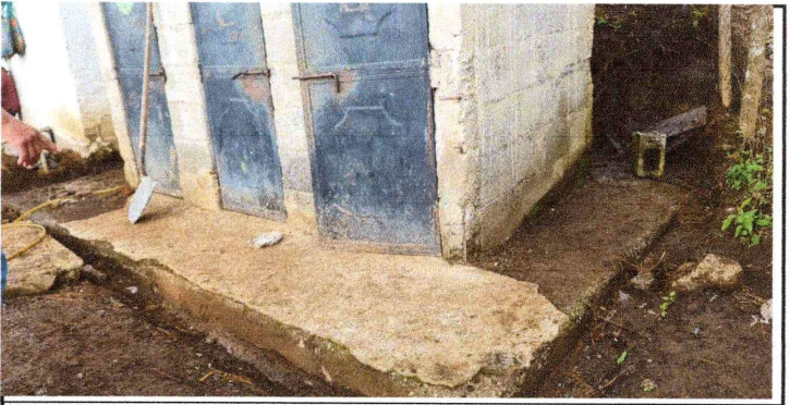
Foto 6: Instalación de migitorios nuevos mejorando con esto el ambiente de sanitarios niños.
