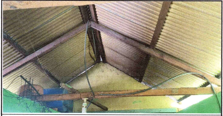
Foto 5: Reparación de sistema eléctrico principal en cocina e instalación de focos nuevos.
